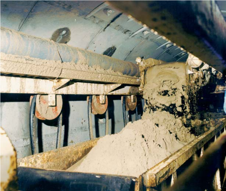
Extracción de material de excavación por cinta. Túnel del colector de Avilés.
